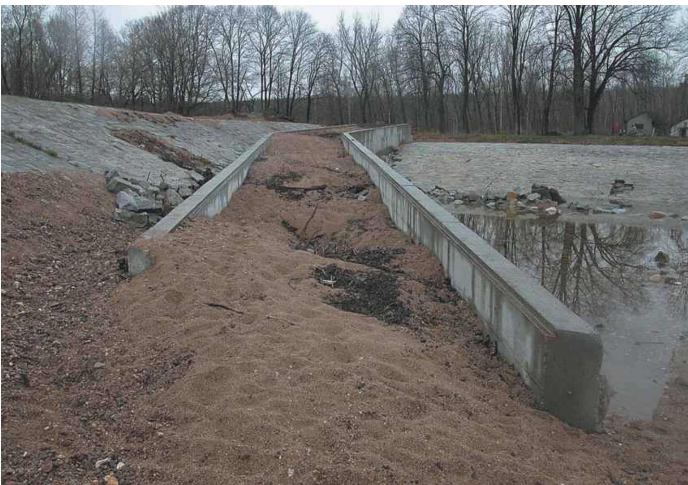
Obiekt który w zamierzeniu miał być przepławką. Zlokalizowany na brzegu wklęsłym rzeki Bóbr we Lwówku Śląskim momentalnie uległ zasypaniu materiałem niesionym przez wodę. Projektant zapomniał, że ryby „lubią” pływać. Fot. Arch. TnZ
